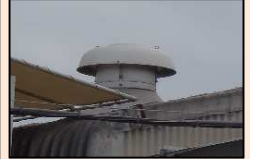
ベンチレーター
