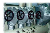
蒸気ヘッダー
